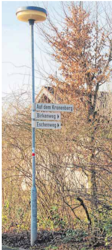
Auf dem Kronenberg soll die Straßenbeleuchtung gegen LED-Technik getauscht werden.
