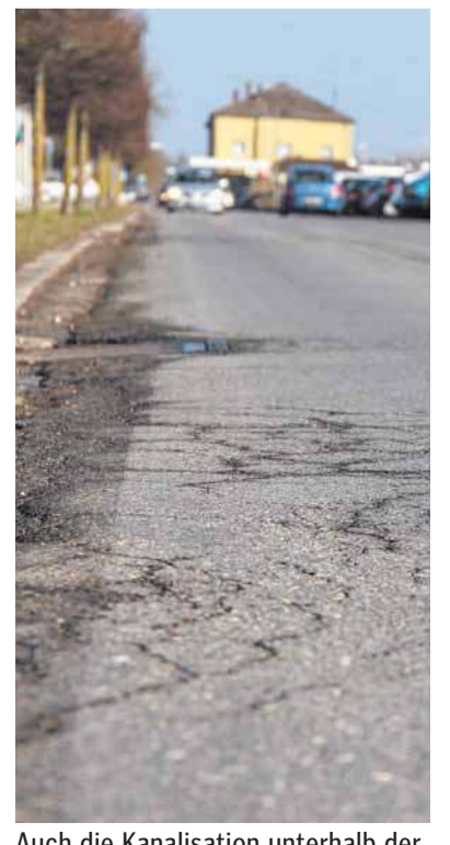
Auch die Kanalisation unterhalb der Poststraße müsste saniert werden.
