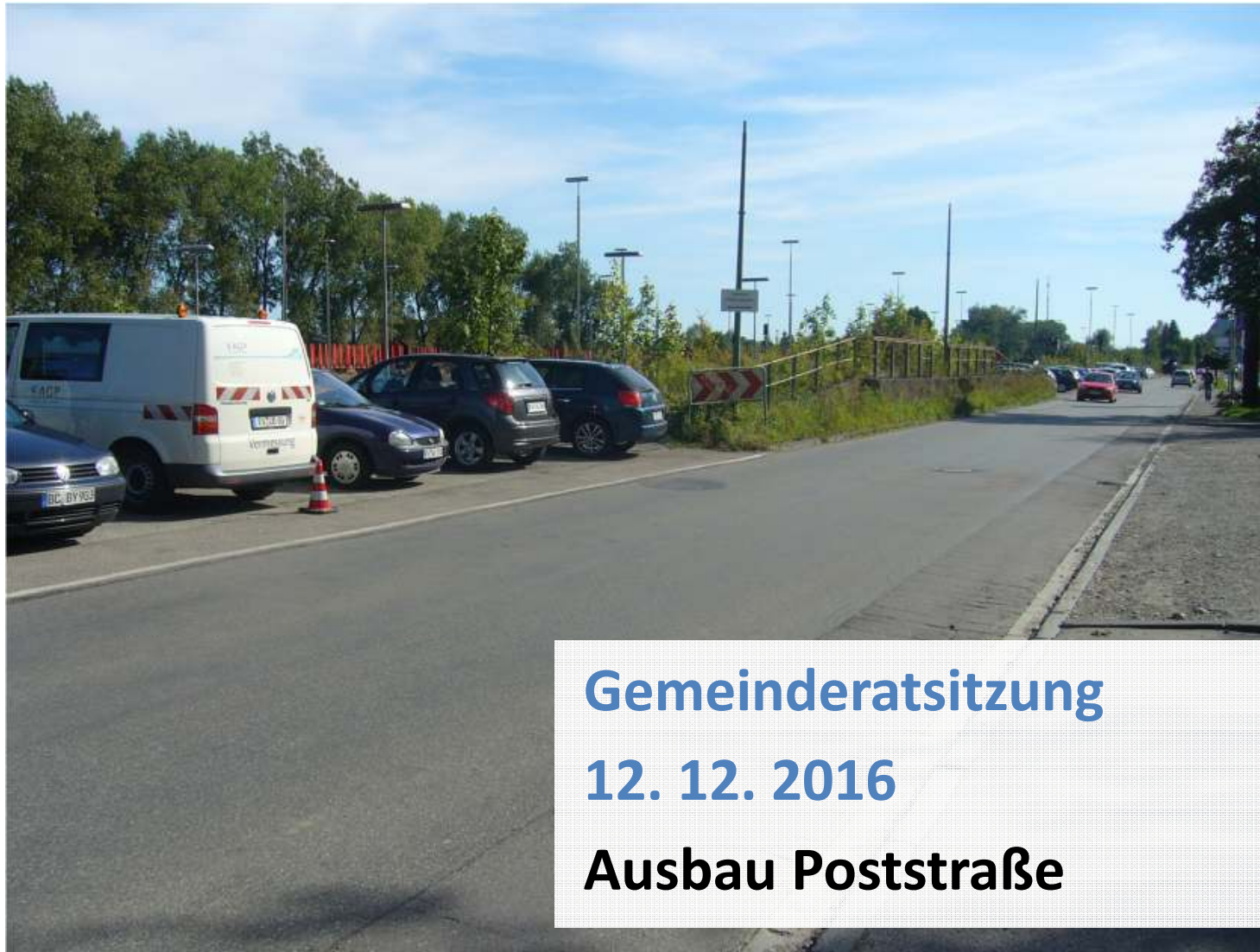
GRS 12.12.2016 / Ausbau Poststraße
